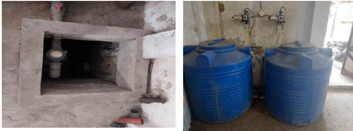
Hình 3. 8. Một số hình ảnh các bể xử lý của trạm xử lý nước thải tại cơ sở
